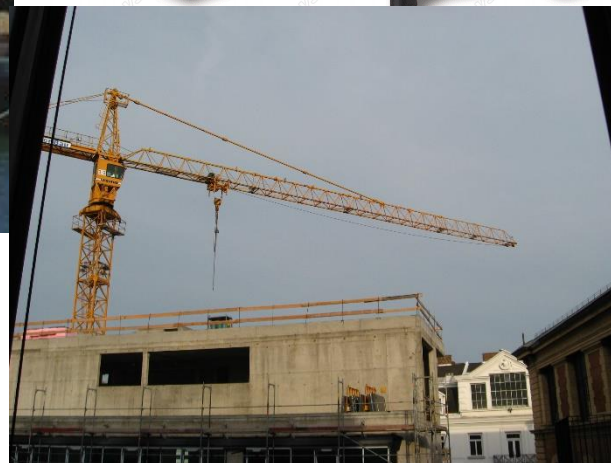
Toranjka dizalica - GSD
